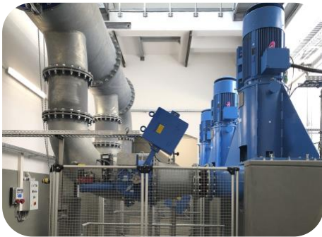
Vorflut-Pumpanlage Leyenburg Bild: LINEG
